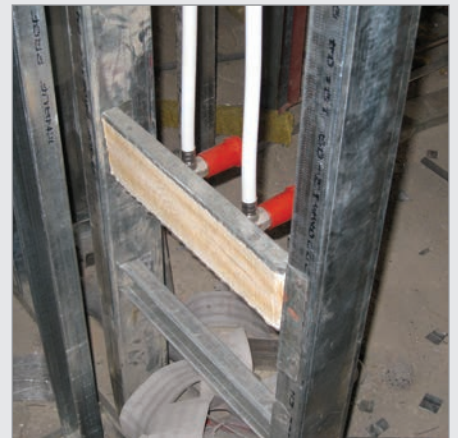
عدم اجرای صحیح جزئیات روشویی
